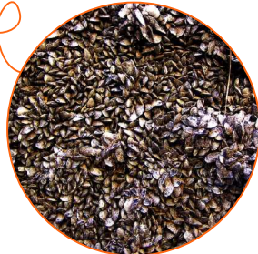
壁面の様子。カワヒバリガイが層をなしてくっついている
